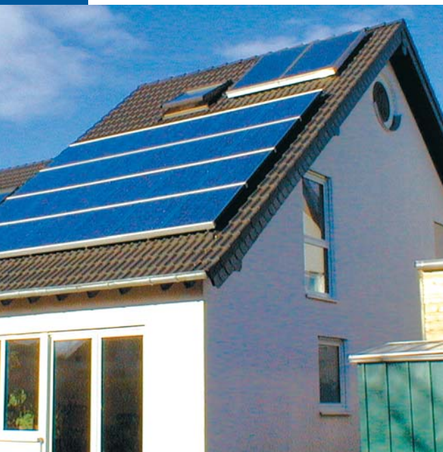
Solarwärme und Solarstrom auf einem Dach genutzt.
